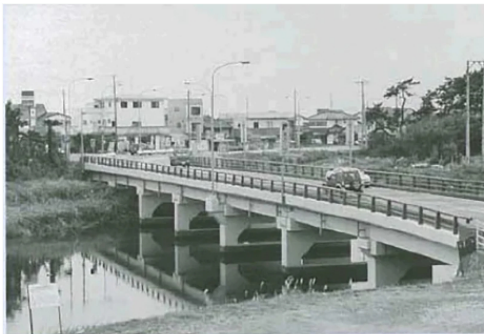
拡幅済みの大北橋（竣工：1930年） 「大北橋の上部工拡幅補強及び下部工拡幅の設計委託」
